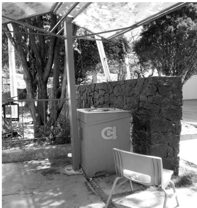
Figura 117. Bebederos poco funcionales y sucios por lo que no son confiables.
